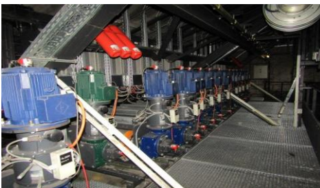
Motoren für die Kulisse/Schnürboden
