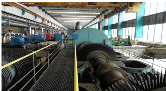
Turbine zerlegt, da in Revision
